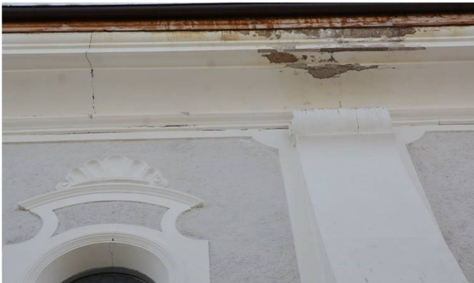
Rissbildung und Wasserschaden beim Gesims
